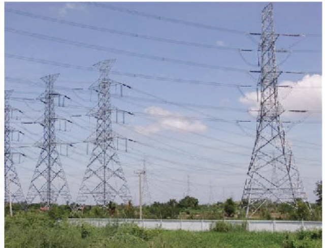
เสาไฟฟ้า
